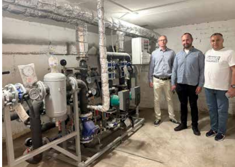
Індивідуальний тепловий пункт, встановлений у багатоквартирному будинку за програмою «Енергодім» у м. Світловодськ.
