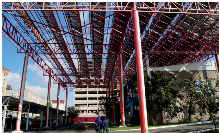
Установка предварительного подогрева воды на солнечных батареях мощностью 1,75 МВт для роторной котельной в Бишкеке. Кыргызстан. 2024 г.
