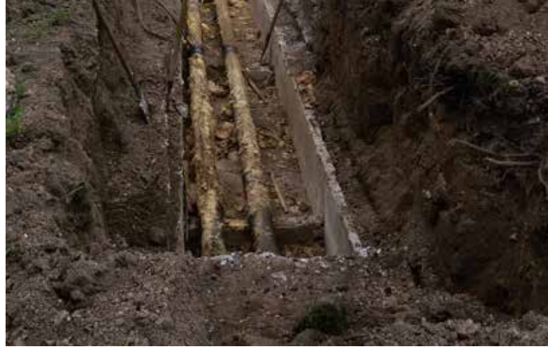
Veraltete Infrastruktur in Swjahel: Leitungen transportieren die Wärme in die Wohnungen. Eine Modernisierung ist dringend notwendig.
