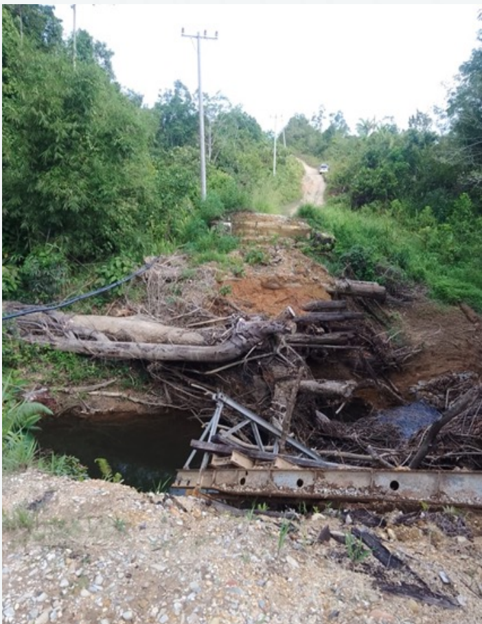
Deskripsi foto: Jembatan rusak dan terputusnya akses ke fasilitas pondok belajar | Photo: ©GIZ/GRASS
